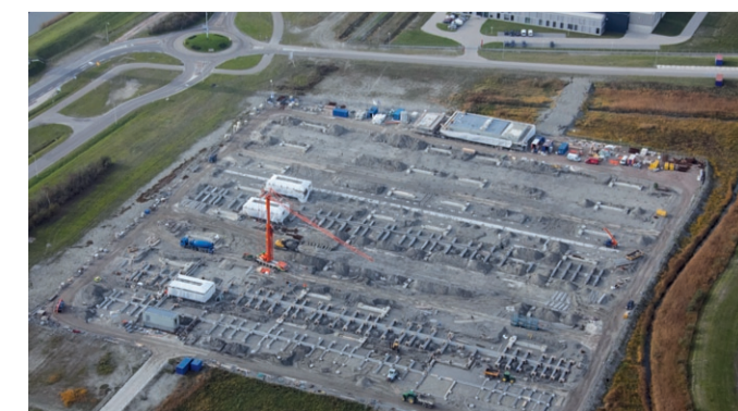
Het bedrijf Tettet is druk bezig met de bouw van een nieuw schakelstation. Dit is nodig voor het transport van de toekomstig beschikbare stroom dat via dit station het landelijk net op gaat.
