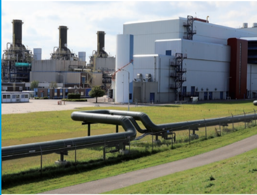
Een deel van de stoomleiding ter hoogte van de Delesto centrale van Nouryon
