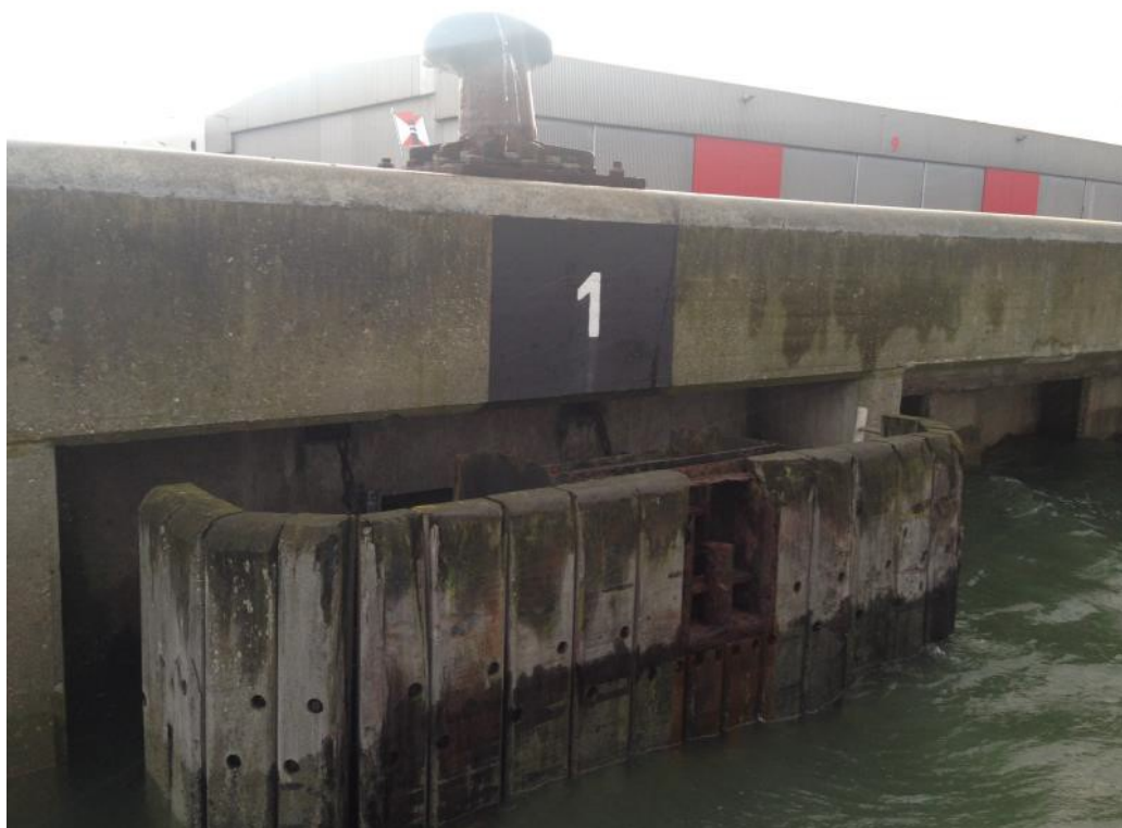
Figuur 4: Een te vervangen Fender
