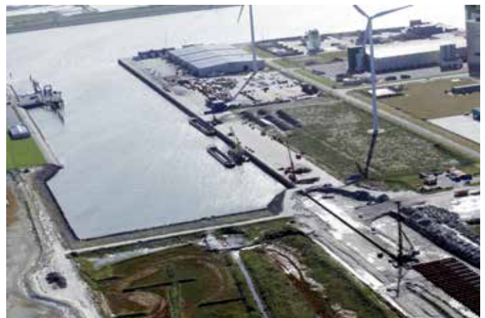
De werkzaamheden voor het verlengen van de zuidkade met bijna 500 meter van de Beatrixhaven zijn in volle gang
