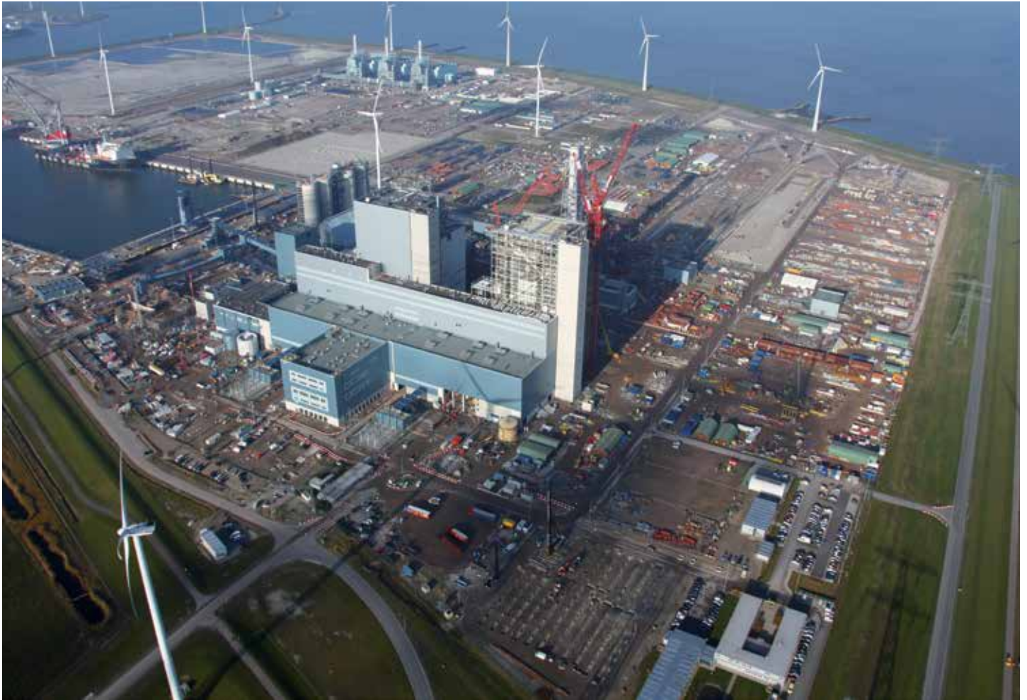
Overzicht Energy Park Eemshaven met op de voorgrond de in aanbouw zijnde kolencentrale van RWE Essent
